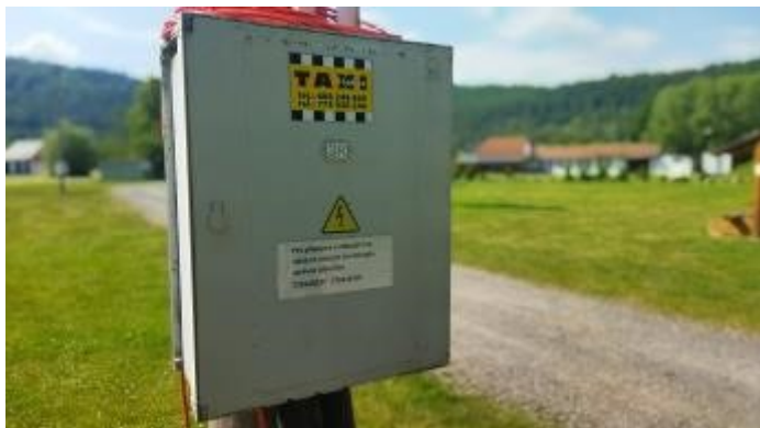
V kempu vyrostlo několik sloupů s elektrickou přípojkou, které slouží obytným vozům. Foto: tf
